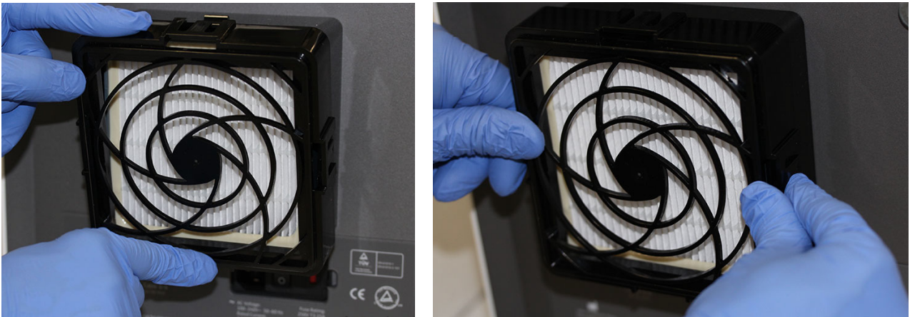
Figure 9-30. Remise en place du dispositif de maintien du filtre HE
